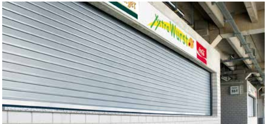
Spezielllösung (extreme Torbreite) in einem Fußballstadion
